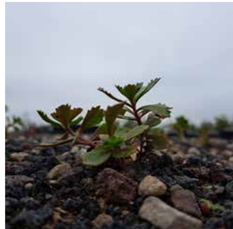
Im Wachstum befindliche Dachbegrünung auf dem Neubau ETR 44. Wir setzen auf die extensive Begrünung unserer Dächer. Diese fördert die Artenvielfalt, bindet Feinstaub, dient als Zwischenspeicher für Regenwasser, hat im Sommer einen kühlenden Effekt auf die PV-Anlage sowie das Gebäude und wirkt im Winter wärmedämmend. Im Vergleich zur intensiven Dachbegrünung profitieren Sie als Mieter von geringeren Herstellungskosten und einem deutlich geringeren Pflegeaufwand. Beide Punkte hätten negative Auswirkungen auf Mietpreis und Betriebskosten.
